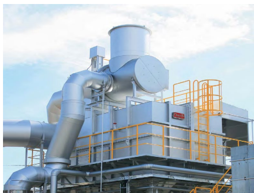
蓄熱式排ガス処理設備
