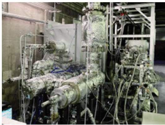
図 5 ラジアントチューブバーナー燃焼試験炉
