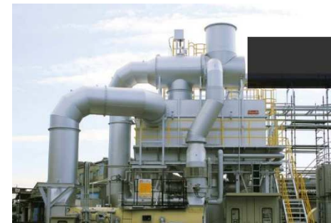
大気浄化設備
