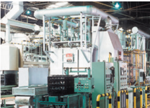
プッシャ型連続ガス浸炭炉
