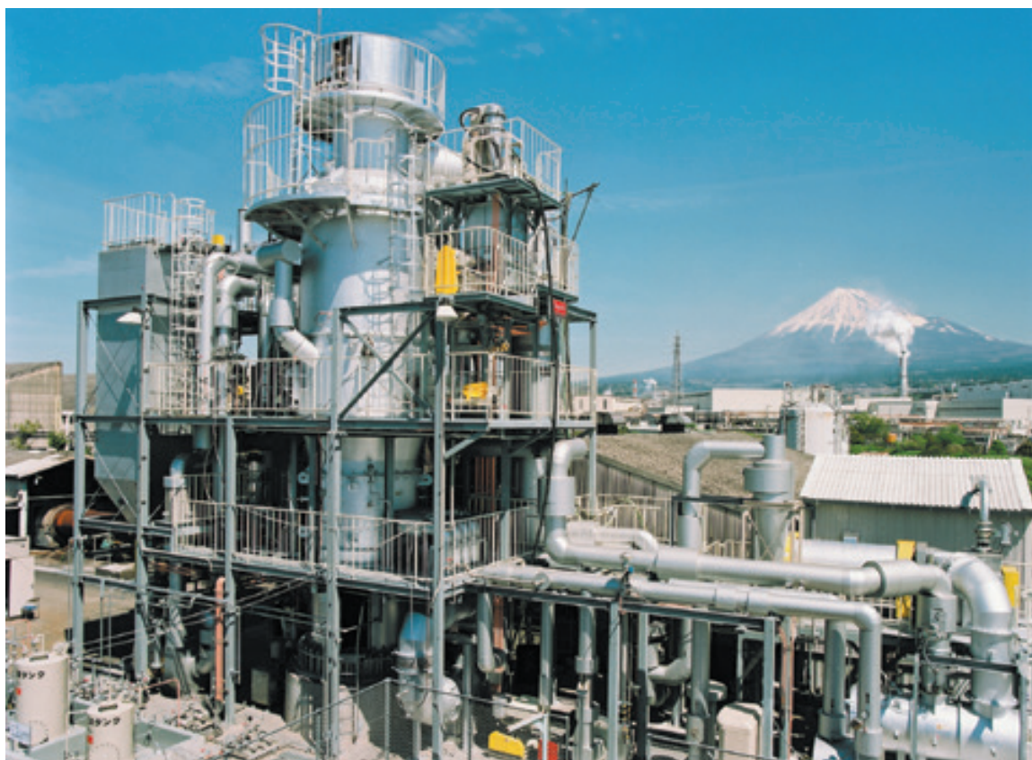
流動床式加熱設備
