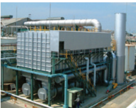
5塔式蓄熱排ガス処理装置 (RTO)
