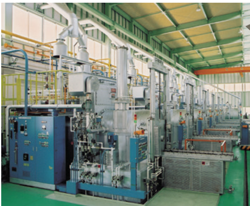
バッチ式ガス浸炭炉 フレームレス ハイ・シフター ® の全自動熱処理ライン
