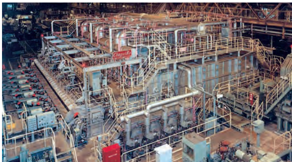
ウォーキングビーム型シームレスパイプ熱処理炉
