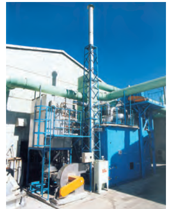
濃縮排ガス処理システム
