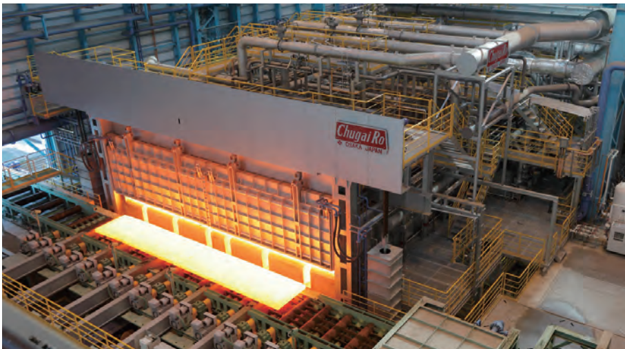
ウォーキングビーム型鋼片加熱炉
