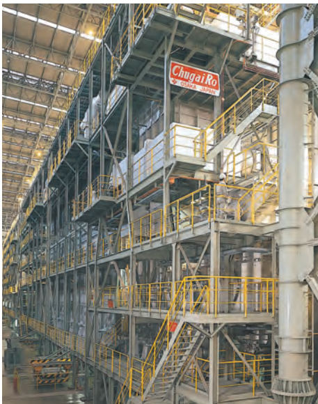
冷延鋼板連続焼鈍設備 (CAL)
