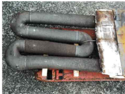
RTチューブ変形
