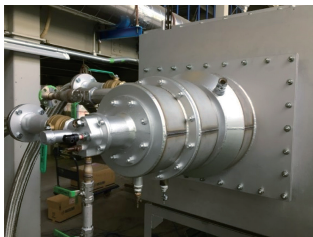
写真 1 100 kW 級アンモニアバーナ外観
