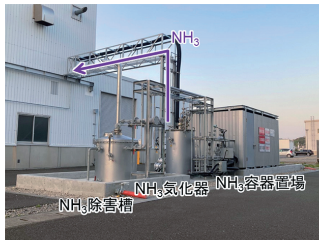
写真 2 アンモニア供給設備の外観（電力中央研究所保有）
