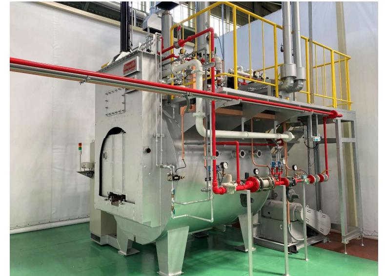
2022年4月に堺事業所に設置したラジアントチューブ型水素燃焼実証炉
